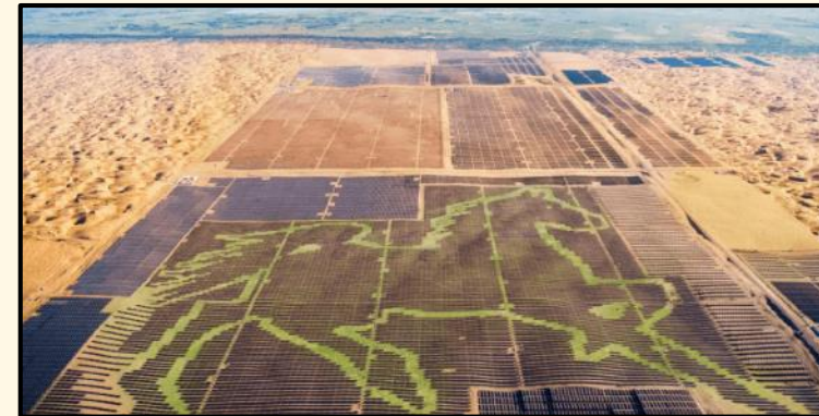
沙漠上的向日葵：光熱發電站
